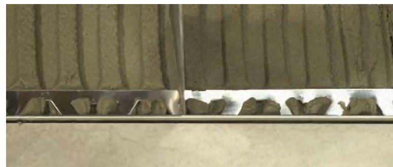
Foto 15: Argamassa colante saindo pelas perfurações
